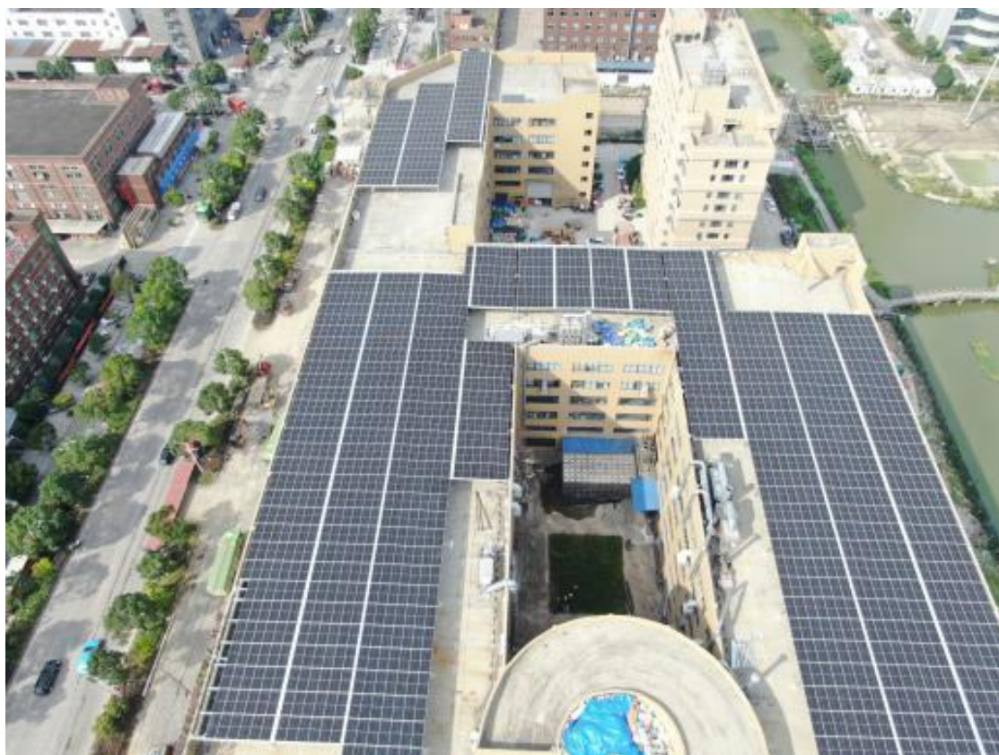
浙江爱德电力配件 972.28kWp 分布式光伏发电项目
