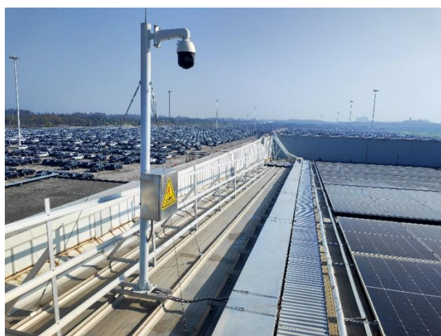
配置高清远红外监控摄像球机，360°实时监控全屋顶光伏设备、光伏停车棚及配电站房进出口，实时监控电站外部环境安全
