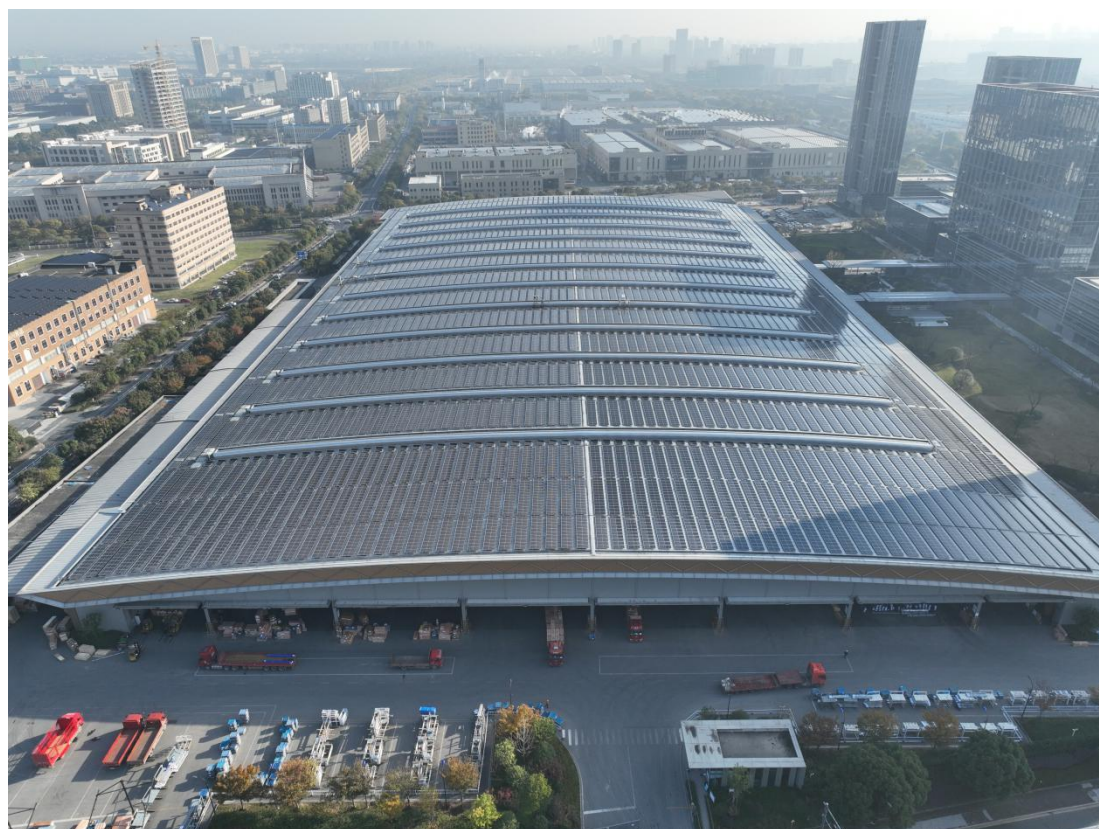
西奥电梯有限公司 5900kWp 屋顶分布式光伏项目
