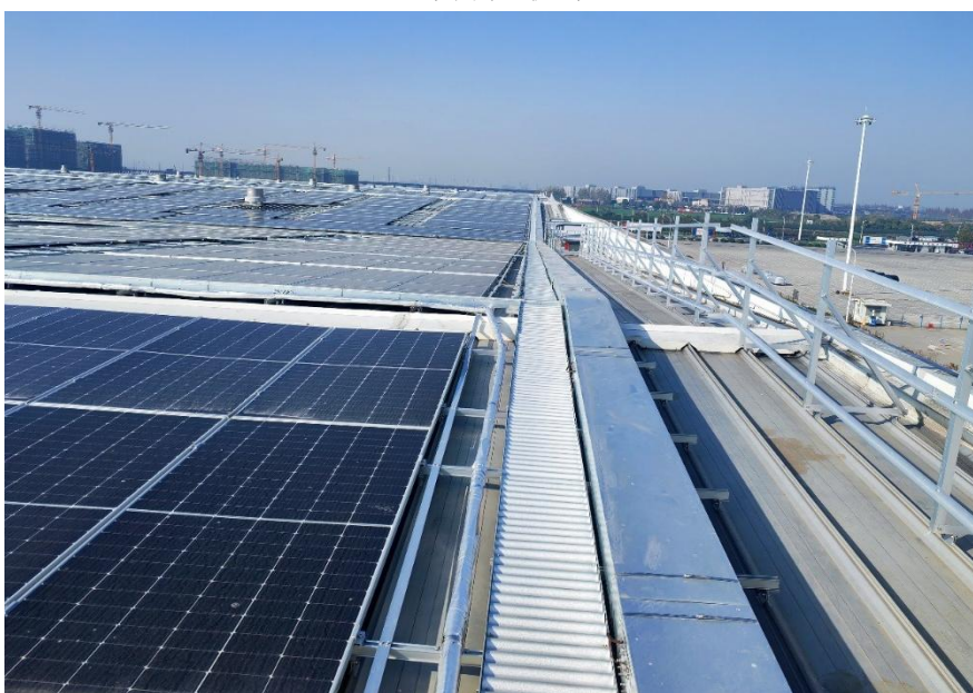
PDC 厂房屋顶光伏及附属设施
