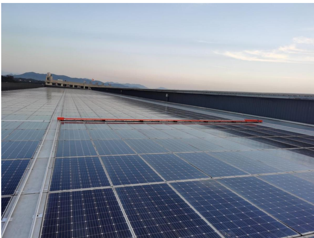
卧龙集团 12.95MW/BAPV+1.55MW/BIPV 分布式光伏+4MWh/用户侧储能项目
