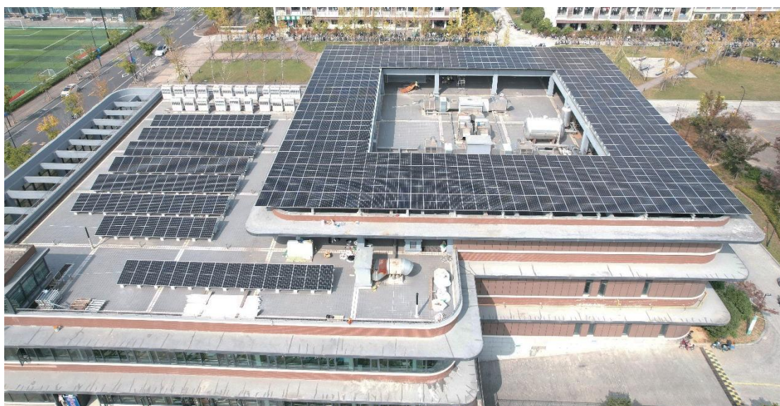
杭师大仓前校区屋顶分布式光伏发电项目
