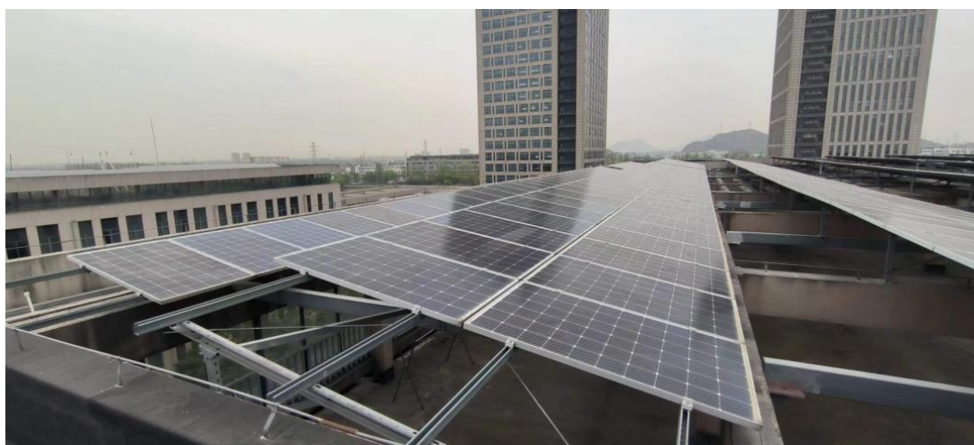
绍兴天裕太阳能柯桥区科技园分布式光伏发电项目
