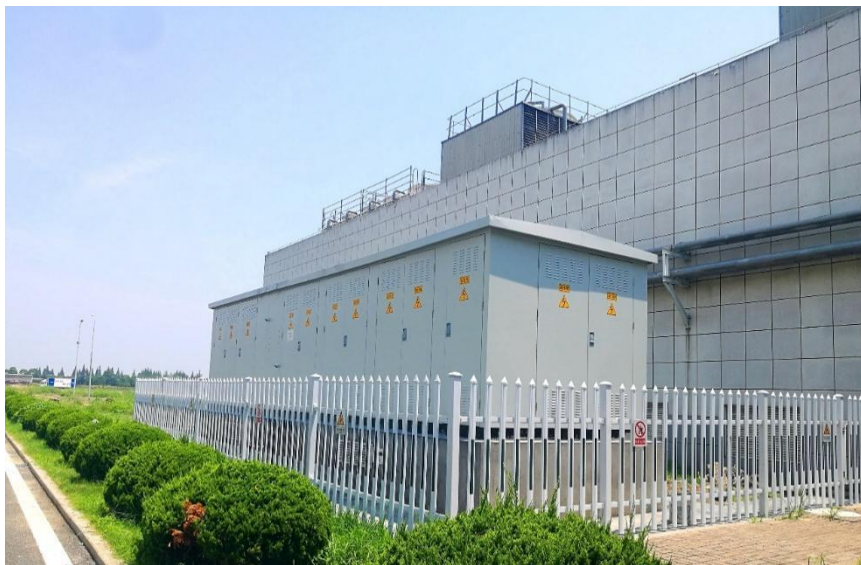
10kV 室外高压配电汇集站
