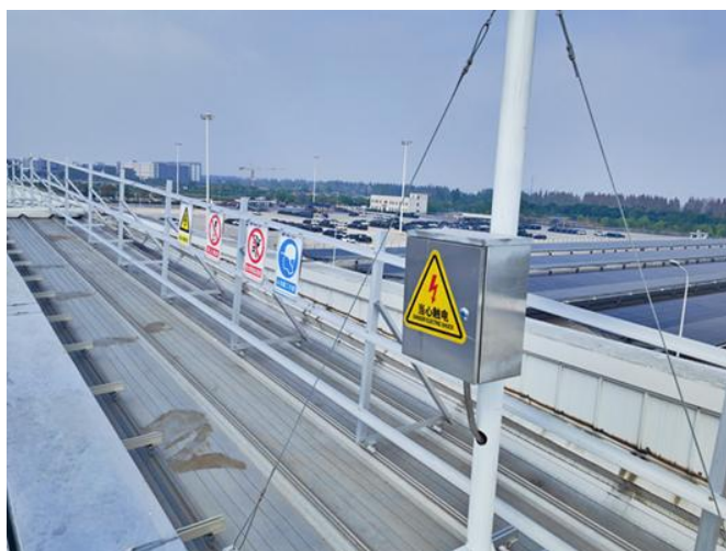
光伏场区、配电区域带电设备设置醒目防触电等标识牌
