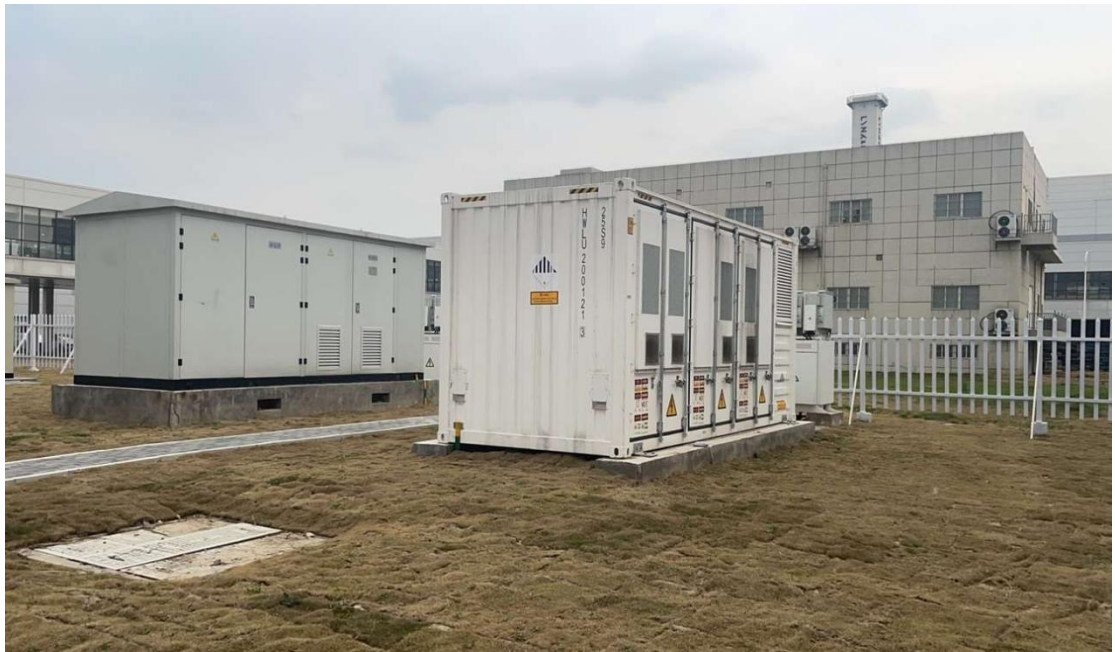
余姚领克汽车工厂 21MW p 分布式光伏+2MWh 储能项目
