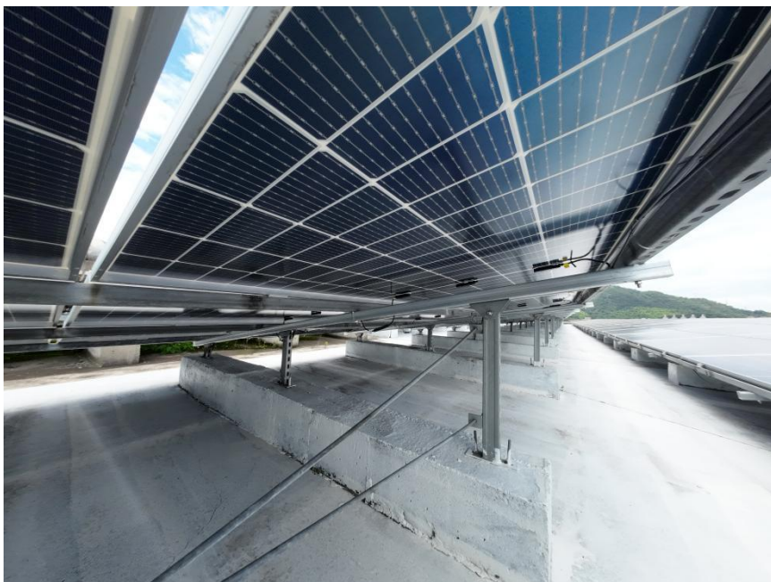
新增高效双面双玻光伏阵列
