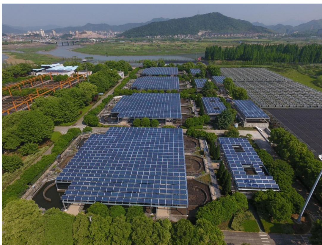
杭州临安排水有限公司污水池面 1.2MW p 分布式光伏发电项目
