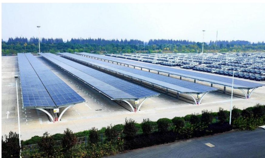
VDC 车库光伏车棚
