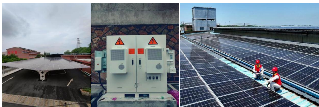
捷安园区光伏、储能单元
