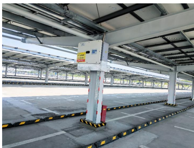
电站光伏停车棚为企业配套安装高标准停车限位装置，并在重点部位增设加强色标警示，有效避免人员与车辆误碰撞与误触电等风险
